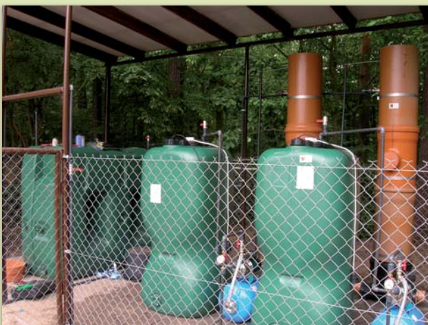
Ryc. 3. System filtracyjny składający się ze zbiornika na wodę „surową” (zielony od lewej), dwóch filtrów piaskowych (pomarańczowe) oraz dwóch zbiorników na wodę przefiltrowaną (zielone po prawej).
