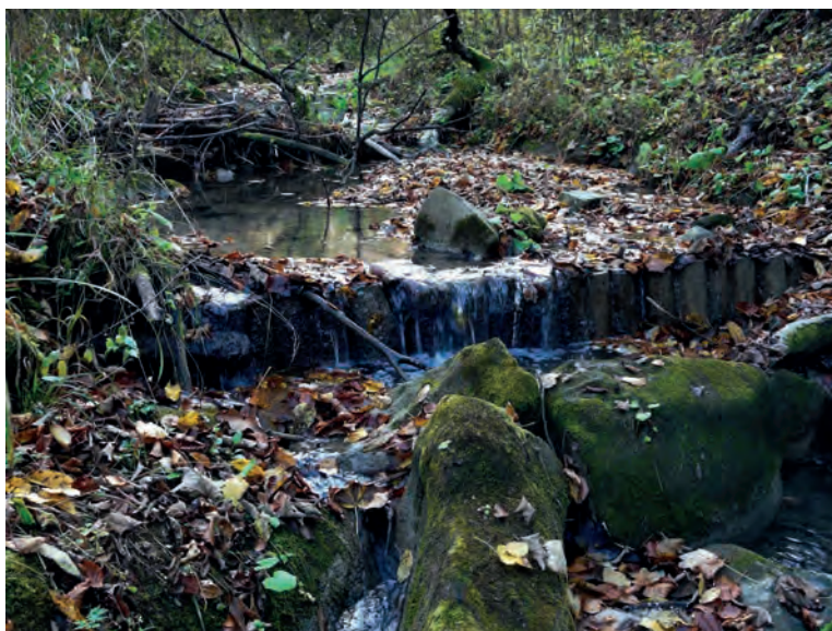
Fotografia 5. Stabilizacja narzutu kamiennego w bystrzu palisadą z „okrągłaków”, wystającą znacznie ponad dno potoku wprowadza przeszkodę dla ichtiofauny przy przepływach niskich (źródło: Algebar 2019)
