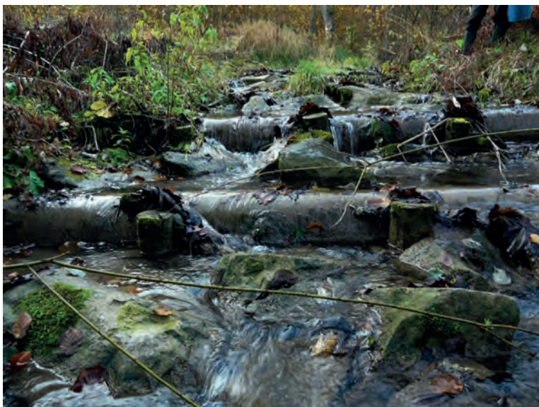
Fotografia 6. Stabilizacja narzutu kamiennego w bystrzu poprzecznie ułożonymi balami drewnianymi wprowadza przeszkodę dla ichtiofauny przy przepływach niskich (źródło: Algebar 2019)
